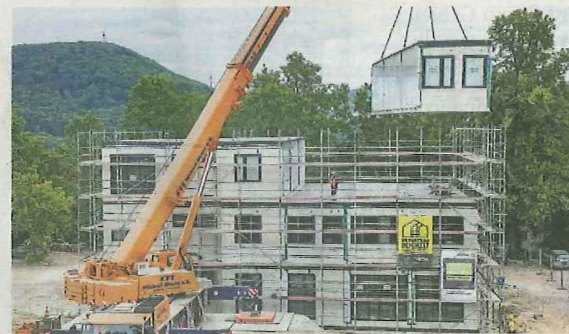
Große Bausteine: Der Neubau der Wilhelmine-Reichard-Schule besteht aus 18 solchen Raummodulen, die diese Woche aufeinander gesetzt wurden. Damit steht der Rohbau.
